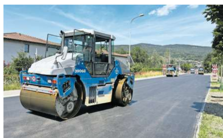
Der Deckbelag auf der Hägendorfstrasse wurde vergangenen Sonntag eingebaut. Bild: Bruno Kissling
